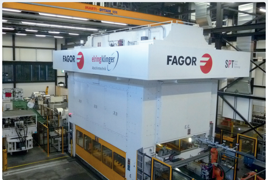
Vollautomatische Pressenstraße bei ElringKlinger
