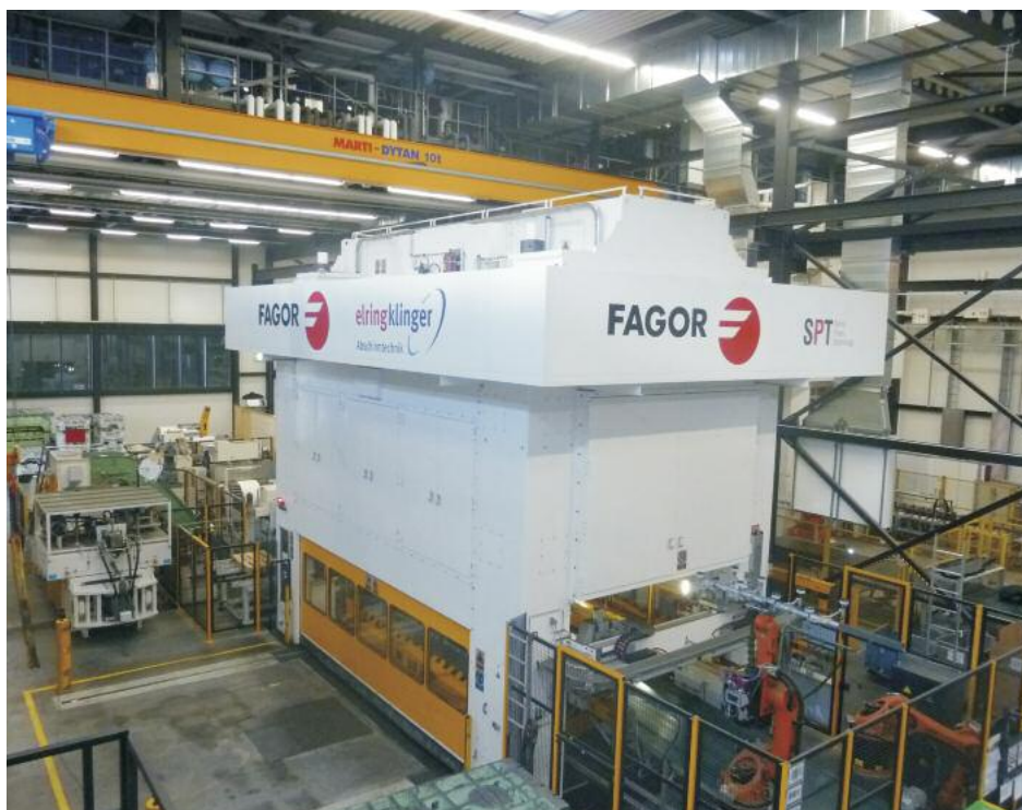
Vollautomatische Pressenstraße bei der Elringklinger Abschirmtechnik (Schweiz) AG in Sevelen. Der Nachschub wird über die Lösung Mobitouch gesteuert
